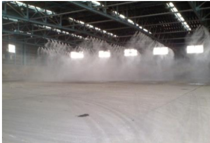
ストックヤード内のミスト噴霧装置
