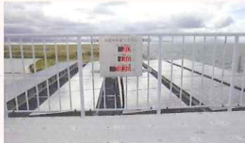
排水処理施設屋上5kW太陽電池モジュール
