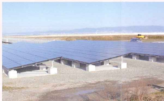
調整池機100kW太陽電池モジュール
